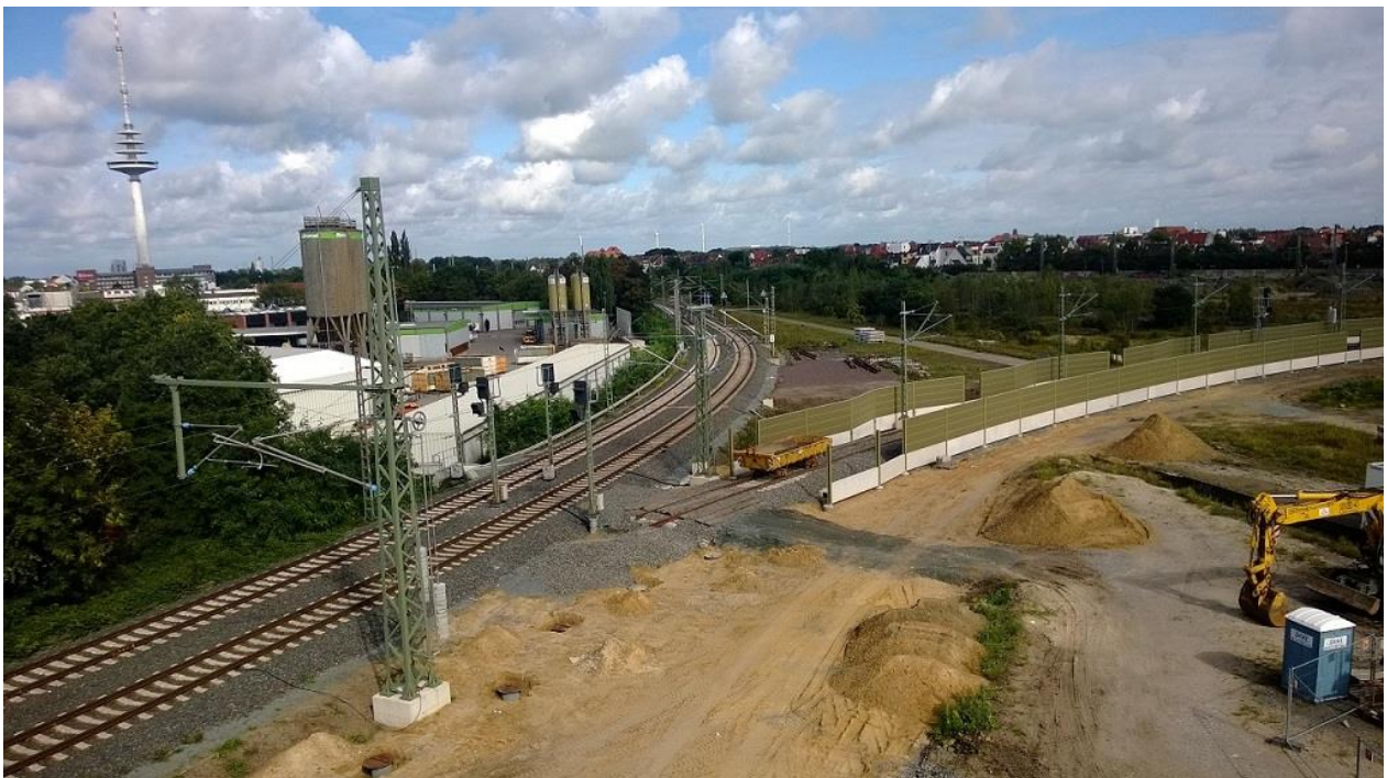
Bild zeigt die bisherige zweigleisige Abfahrt nach Bremen-Nord. Die Weichen müssen noch eingebaut werden, ebenso der Anschluß der Oberleitung.
